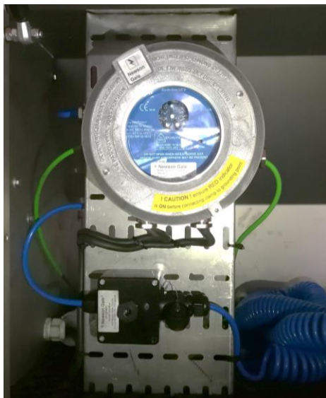
► 接地检测系统
